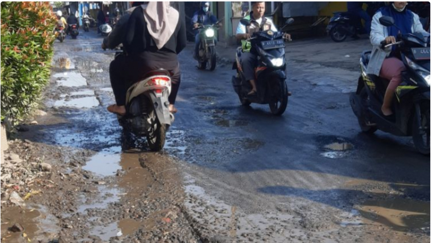
Kondisi Jalan Industri Tarik Kolot ( Dok. Pribadi)
